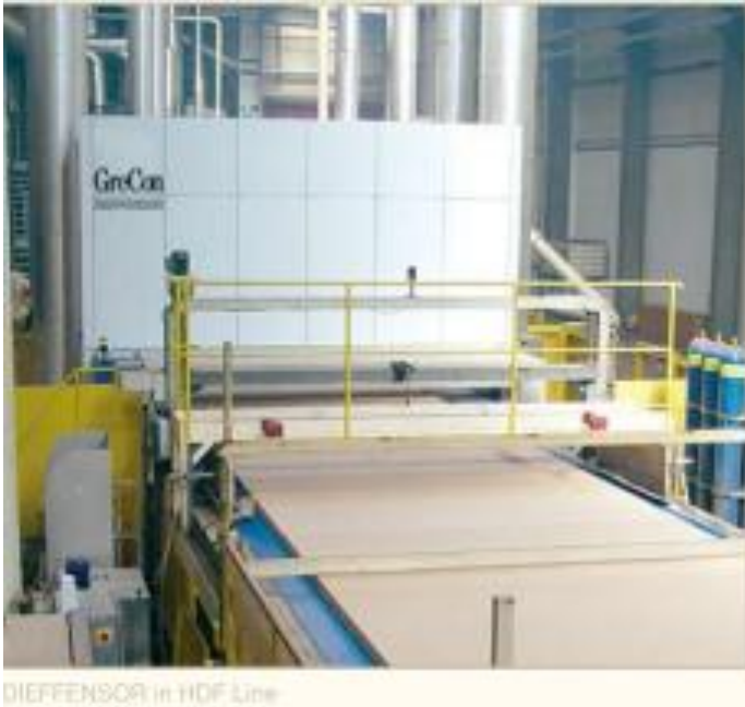
HDF 製造ラインにおけるディフェンザー
